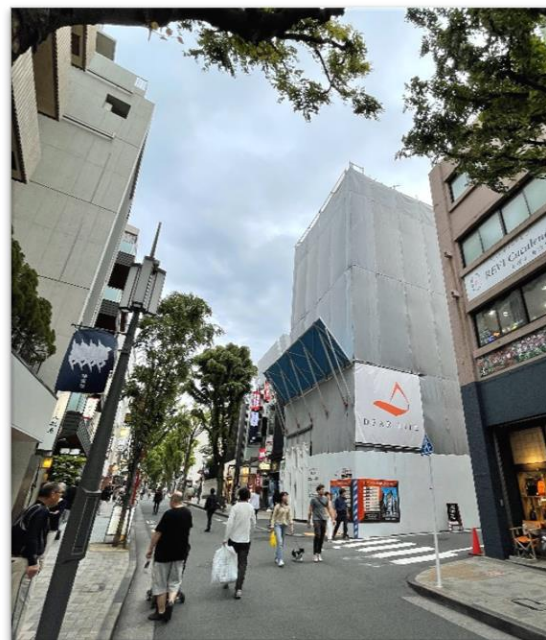
◀ 神楽坂5丁目PJ 2023年7月竣工予定 神楽坂商店街沿い 店舗・事務所を開発
